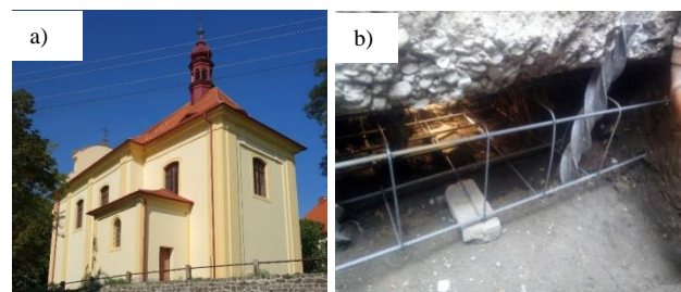
Fot. 4. Kościół św. Wacława w Dlazkovicach w Czechach : a) widok ogólny, b) wzmocnienie ławy fundamentowej Photo 4. St. Wencesla's Church in Dlazkovice, Czech Republic: a) general view, b) reinforcement of the strip footing
