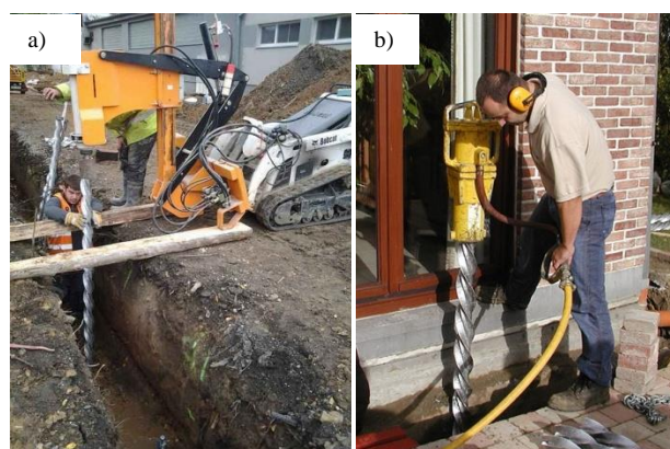
Fot. 2. Montaż mikropali aluminiowych: a) z użyciem jezdznego młota pneumatycznego, b) z użyciem ręcznego młota pneumatycznego Photo 2. Assembly of aluminum micropiles: a) with the use of a mobile pneumatic hammer, b) with the use of a manual pneumatic hammer
